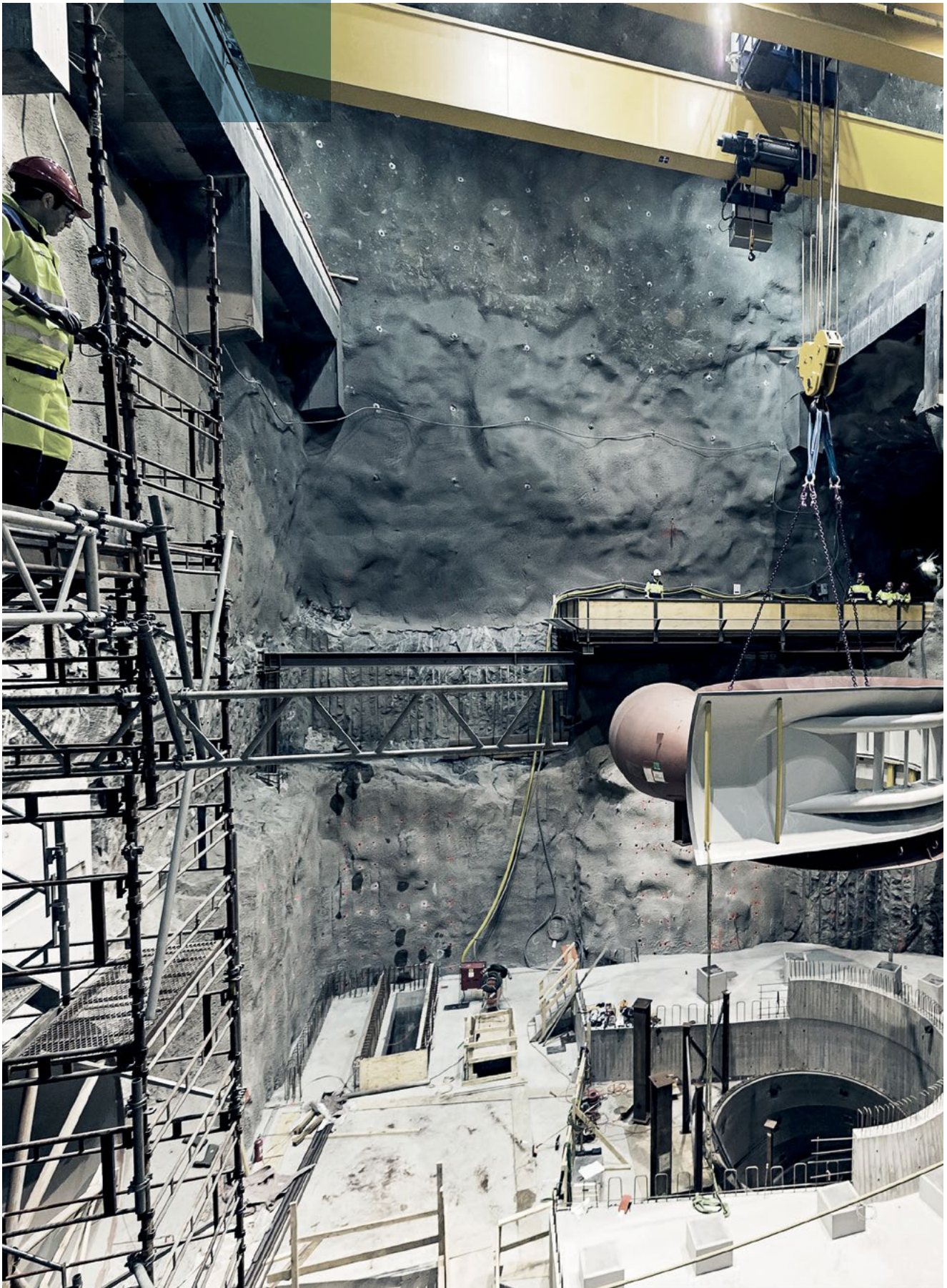
Ny Iveland spiraltrømmel. Foto: Agder Energi
