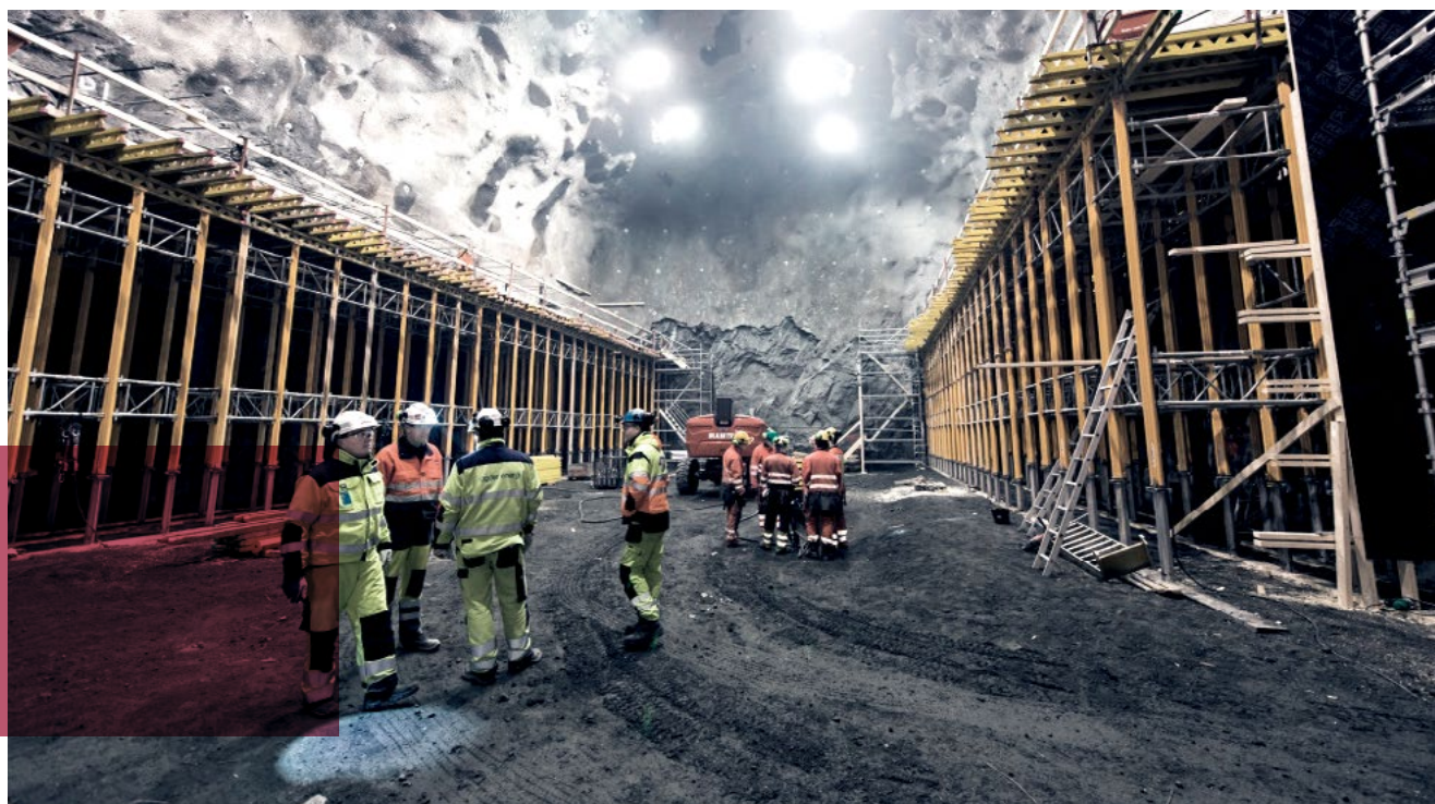
Maskinhallen - Iveland. Foto: Agder Energi
