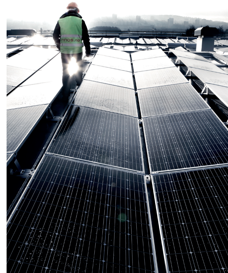
Solcellanlegg på lagertaket til ASKO på Vestby. Foto: Solenergiklyngen
